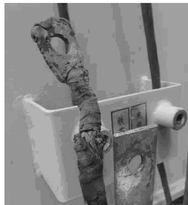
图1 铁心接地引下线靠近接地端子处绝缘护套烧损情况
